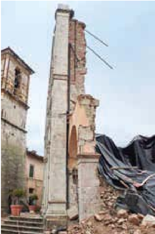
Fig. 3. La precarietà della facciata (foto di G. Capponi, 2016).
