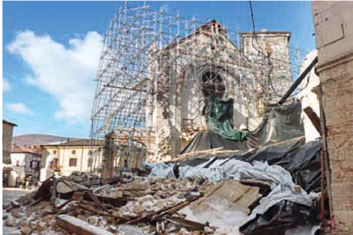
Fig. 4. I crolli lungo via Mazzini dopo la messa in sicurezza della facciata (foto di M.E. Corrado, 2017).
